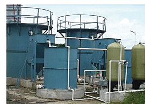
AF (Anaerobic Filter)
