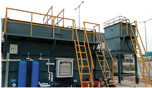
Kalyani Techno Forge LTD (ETP + STP)
